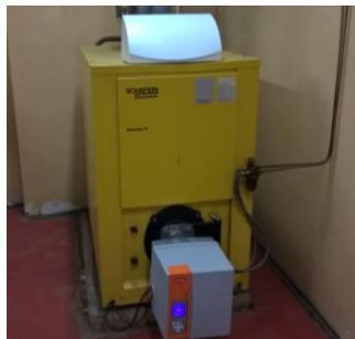
Zdj. 1. Stary kocioł olejowy w jednym z budynków pilotażowych
