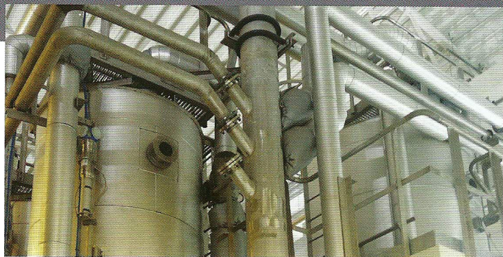
Fot. 1. Instalacja do hydrolizy termicznej, Lindum AS (fot. P. Płonka)
